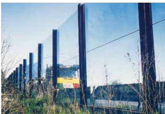
Průhledná protihluková stěna
