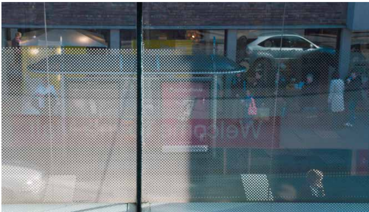
V závislosti na světle mají vzory na skle různé účinky. Tato výloha je pokryta velmi hustým tečkovaným vzorem. Zatímco pravá strana ve stínu je poloprůhledná a je skrz ni vidět, levá strana je mnohem více zastíněná. Pro prevenci kolizí nemusí být vzor takto hustý.
