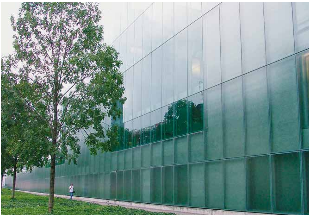
Ukázka špatné výsadby: stromy stojí přímo před částmi budovy s vysoce odrazivým sklem. Během jediného podzimu zde uhynuly stovky sýkor uhelníčků. Tato překážka v krajině, kterou prochází migrační trasa, blokuje let ptáků. Odrazy stromů vytvářejí iluzi volného průletu.
