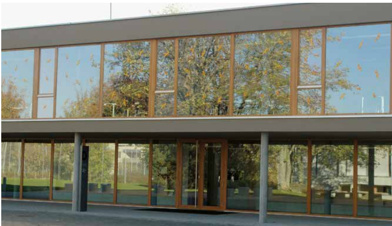
Nová školní budova s širokou, dvoupatrovou prosklenou fasádou. Kvůli věrnému zrcadlení zeleně docházelo k neustálým kolizím ptáků. Zoufalí žáci spolu s učitelem biologie vytvořili barevné siluety. Nebezpečí kolizí se sice snížilo, avšak problém i tak není dosud uspokojivě ani účinně vyřešen.
