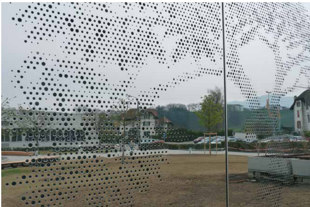
Kovové panely s vysokou odrazivostí na této budově jsou pro ptáky nebezpečné. Nebezpečí bylo zmírněno okrasnou perforací. V panelech jsou však stále velké plochy neperforovaného kovu, u kterých nebezpečí kolize přetrvává.
