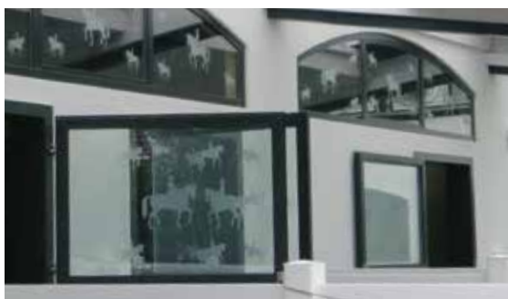
Na konstrukci tohoto jezdeckého centra bohužel nebylo dodrženo pravidlo velikosti dlaně
