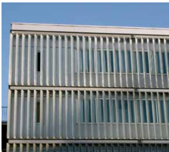
Svislé či vodorovné žaluzie zastíňují a zároveň strukturují fasádu; jsou-li nainstalovány hustě jako na tomto příkladu, je nebezpečí minimální
